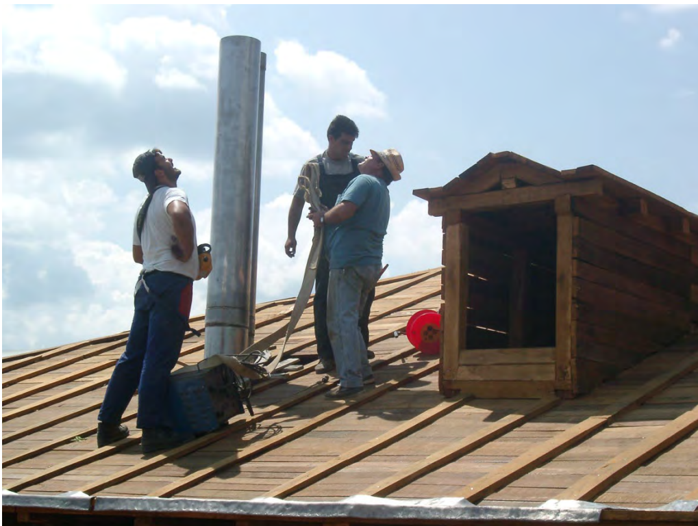
Φωτογραφία 68: Ανοξείδωτοι σωλήνες καμινάδας
