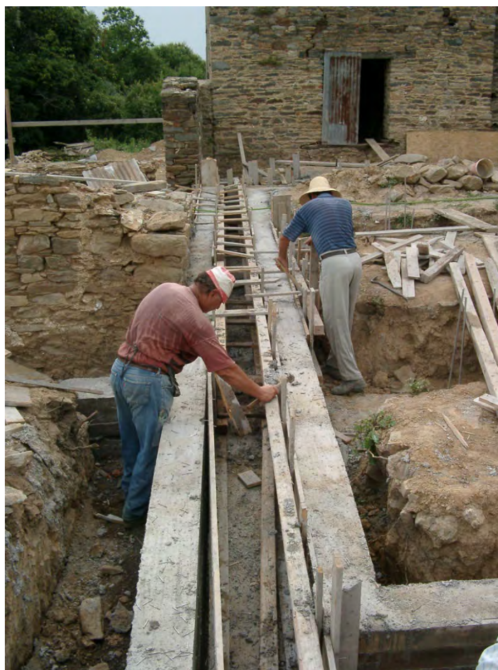
Φωτογραφία 33: Κανάλι διέλευσης σωληνώσεων
