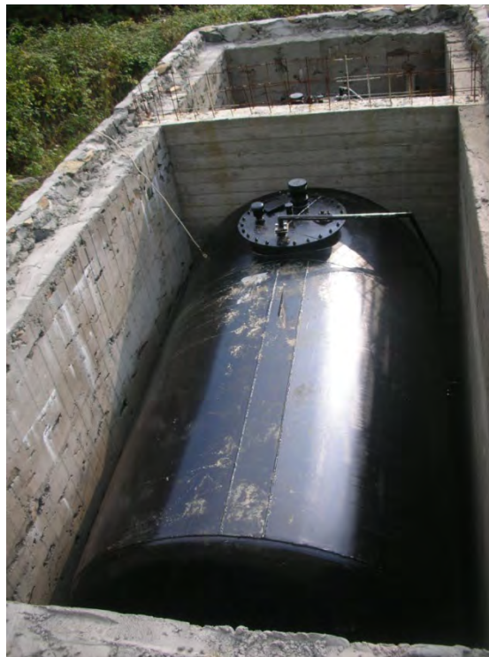
Φωτογραφία 178: Μεταλλική δεξαμενή καυσίμων
