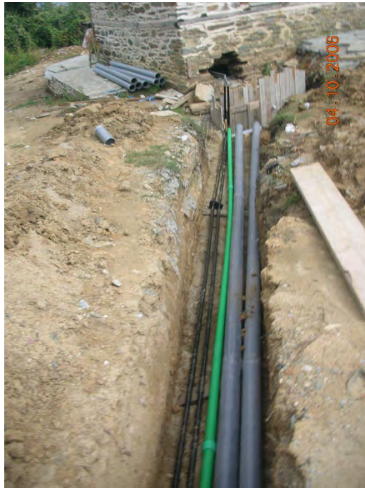
Φωτογραφία 53: Διέλευση σωληνώσεων προς Λεβητοστάσιο
