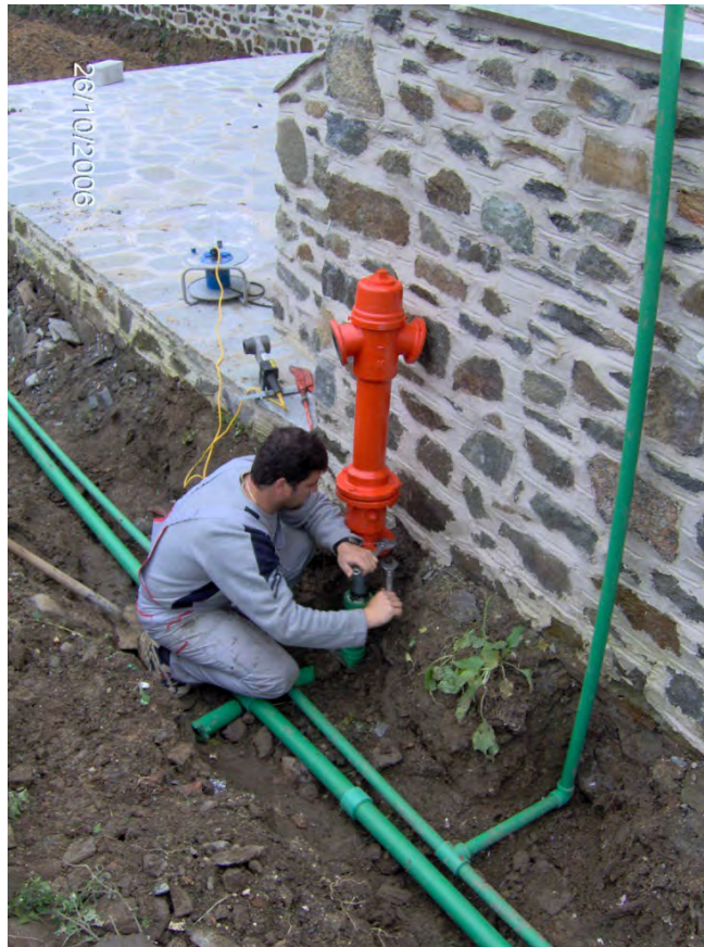
Φωτογραφία 173: Σύνδεση πυροσβεστικών κρουνών
