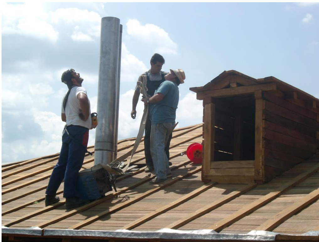
Φωτογραφία 68: Ανοξείδωτοι σωλήνες καμινάδας
