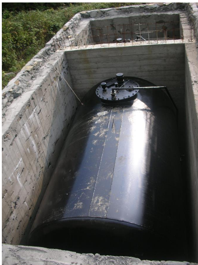
Φωτογραφία 178: Μεταλλική δεξαμενή καυσίμων
