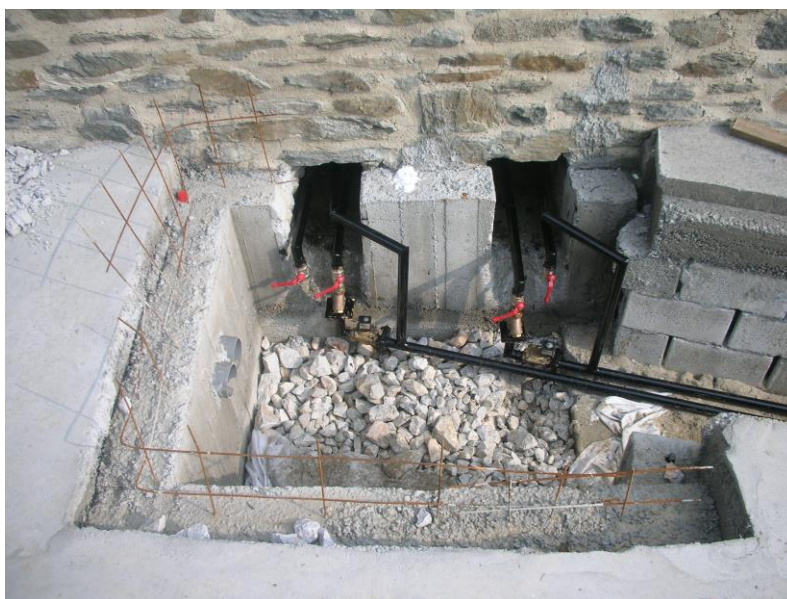
Φωτογραφία 183: Συνδέσεις ηλεκτρομηχανολογικών εγκαταστάσεων
