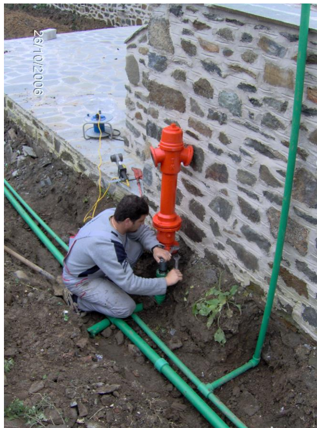
Φωτογραφία 173: Σύνδεση πυροσβεστικών κρουών
