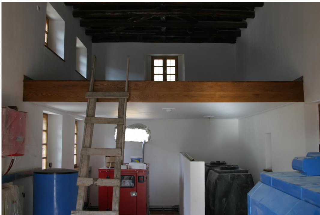
Φωτογραφία 184: Πατάρι και διαχωριστικοί τοίχοι λεβητοστασίου
