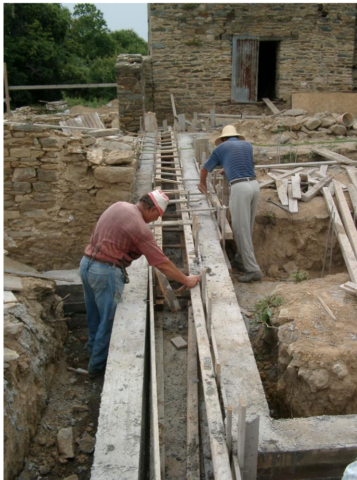
Φωτογραφία 33: Κανάλι διέλευσης σωληνώσεων
