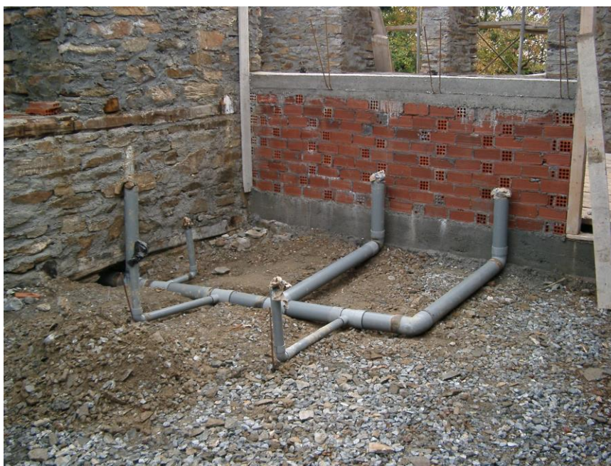
Φωτογραφία 34: Σωληνώσεις αποχετεύσεων-Πλινθοδομές
