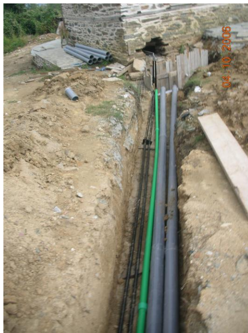
Φωτογραφία 53: Διέλευση σωληνώσεων προς Λεβητοστάσιο
